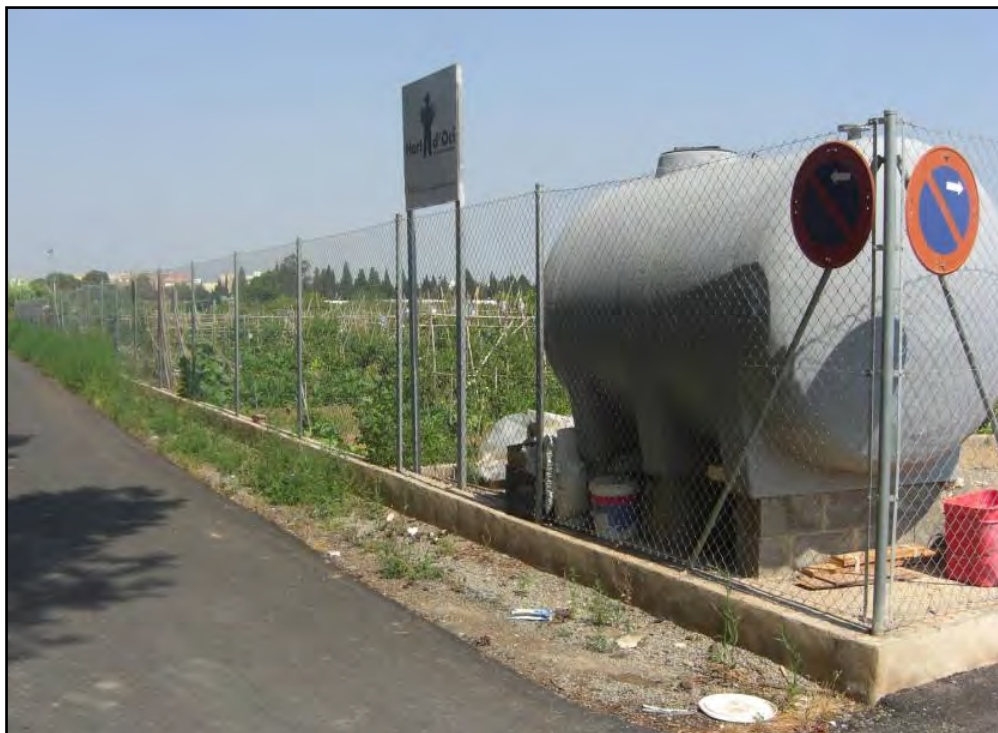
Detalle del panel presentación del huerto y del depósito de riego
