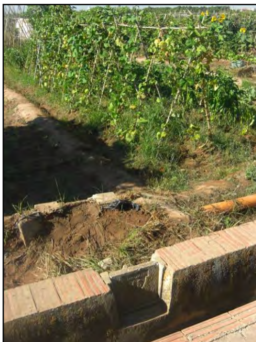
Detalle de la acequia de riego
